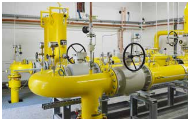
Gas-Druckregelanlage auf Werksgelände
