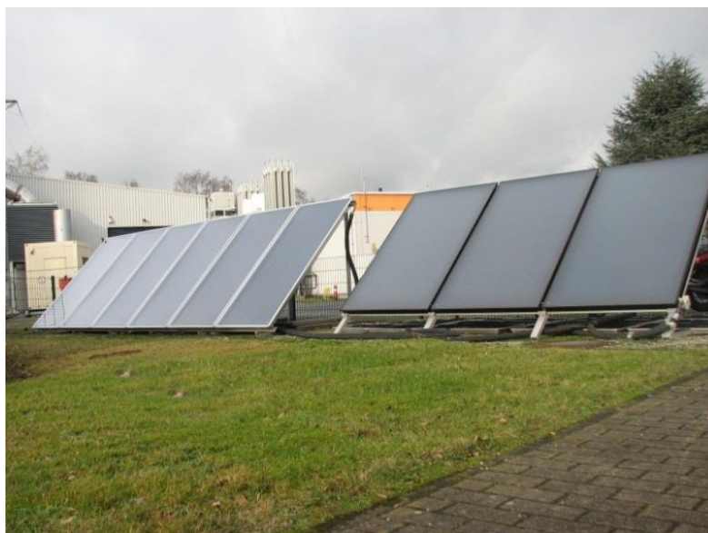
Abbildung 6-4: Solarthermiemodule für die Brennwert plus Solar- und Gaswärmepumpenanlage
