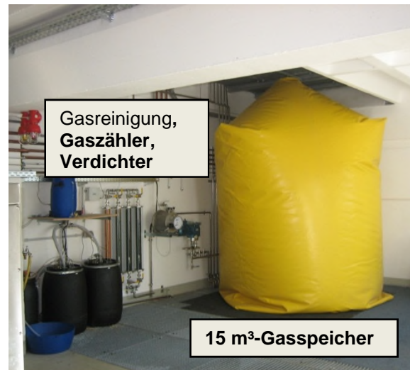
Abbildung 4-7: Biogasspeicher und Biogasstrecke
