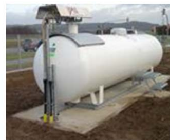
Konditionierung: LPG (Flüssiggas) 30-Tonnen-Tanklager
